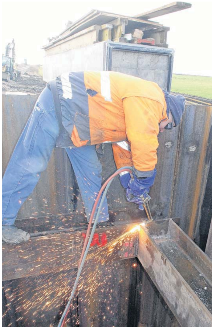
Ein Teil des Stahls in der Mitte der Spundwand-Konstruktion wird wieder entfernt, schließlich soll hier künftig die Ibitz hindurchfließen.
